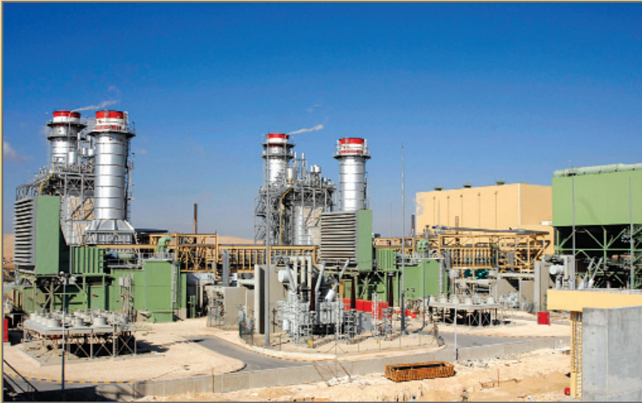
منظر عام لمحطة السمرا لتوليد الكهرباء
